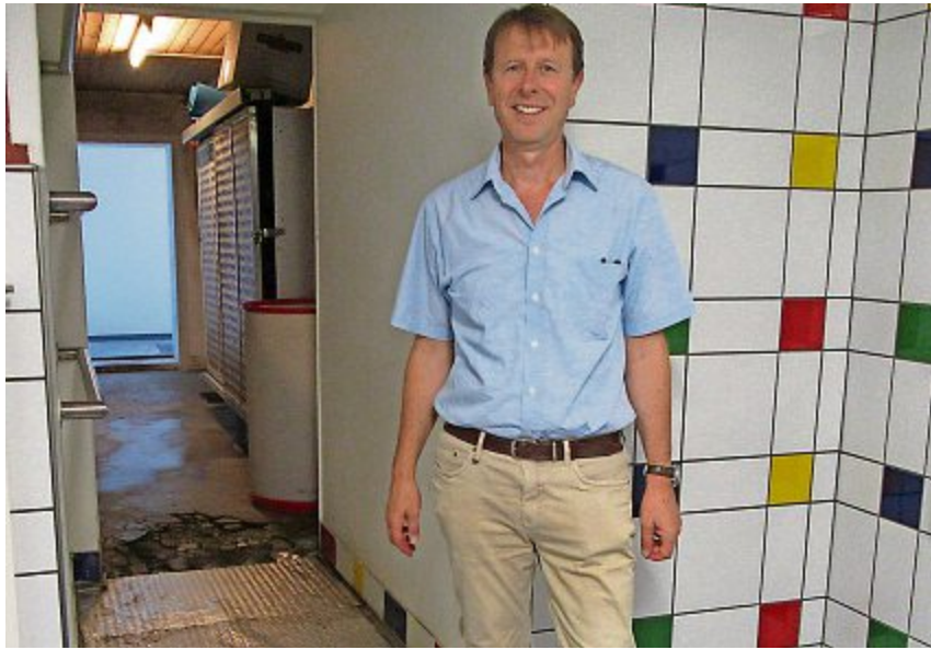
Lucio Schiavi, Präsident des FC Bülach, auf einem Rundgang durch den verschimmelten Duschaum. Im Hintergrund ist das Loch im Boden sichtbar.
